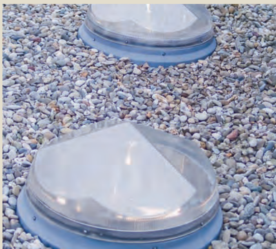
Annick geniet volop van de overvloedige lichtaanvoer door de diamantvormige 'sunpipes'. Foto's Debbie Debrouwere
